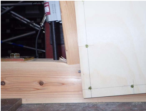
(a) 柱の土台へのめり込み
