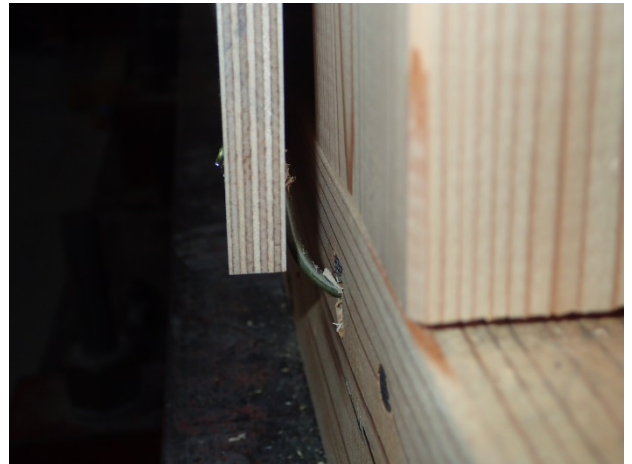
(b) 接合くぎ軸部の土台からの抜け出し
