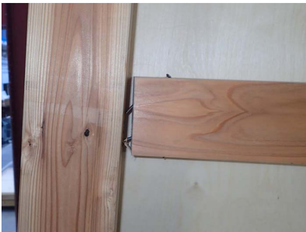
(c) 胴つなぎ留め付けくぎの抜け出し
