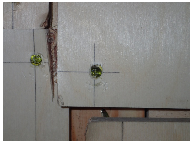
(d) 接合くぎ頭部の面材へのめり込み
