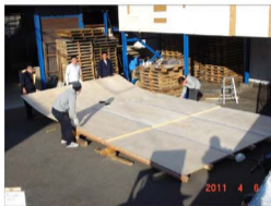
7・ 完成したドームパネルの片側（この場合は右側）を 根本側のストッパーブロックに当てて建て起こしを 開始。*女性の力ではやや不足
